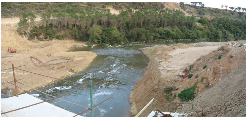
Figura 5-17. Obras en el cauce del río Arga con afecciones a todos los componentes de cauce y ribera.
