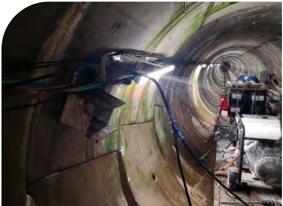
Interior túnel hidráulico Jalón - Grío
