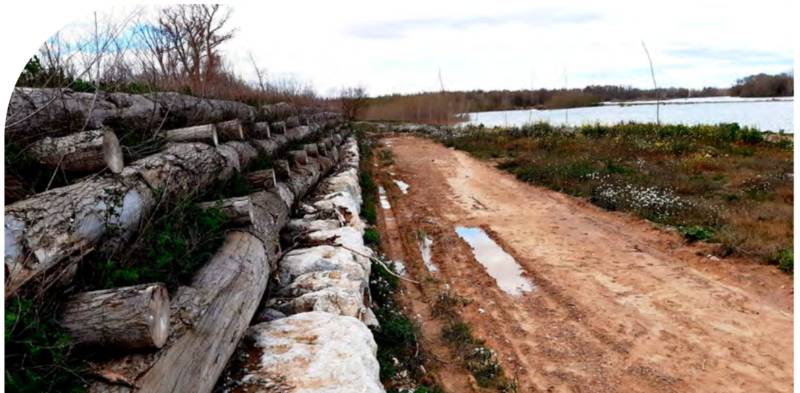
Muro Krainer en mota del río Ebro en "El Estajao" (La Rioja)
