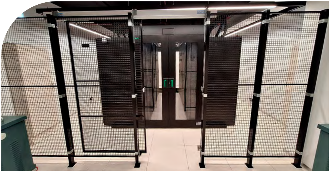
Armarios de alojamiento para servidores y equipos de comunicaciones del nuevo centro de procesamiento de datos
