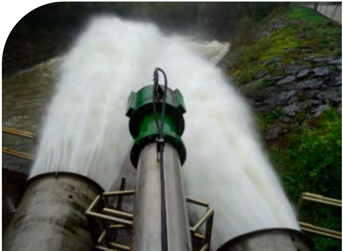
Apertura de los desagües de fondo con el caudal máximo de 8.500 litros por segundo (26/10/2023).
