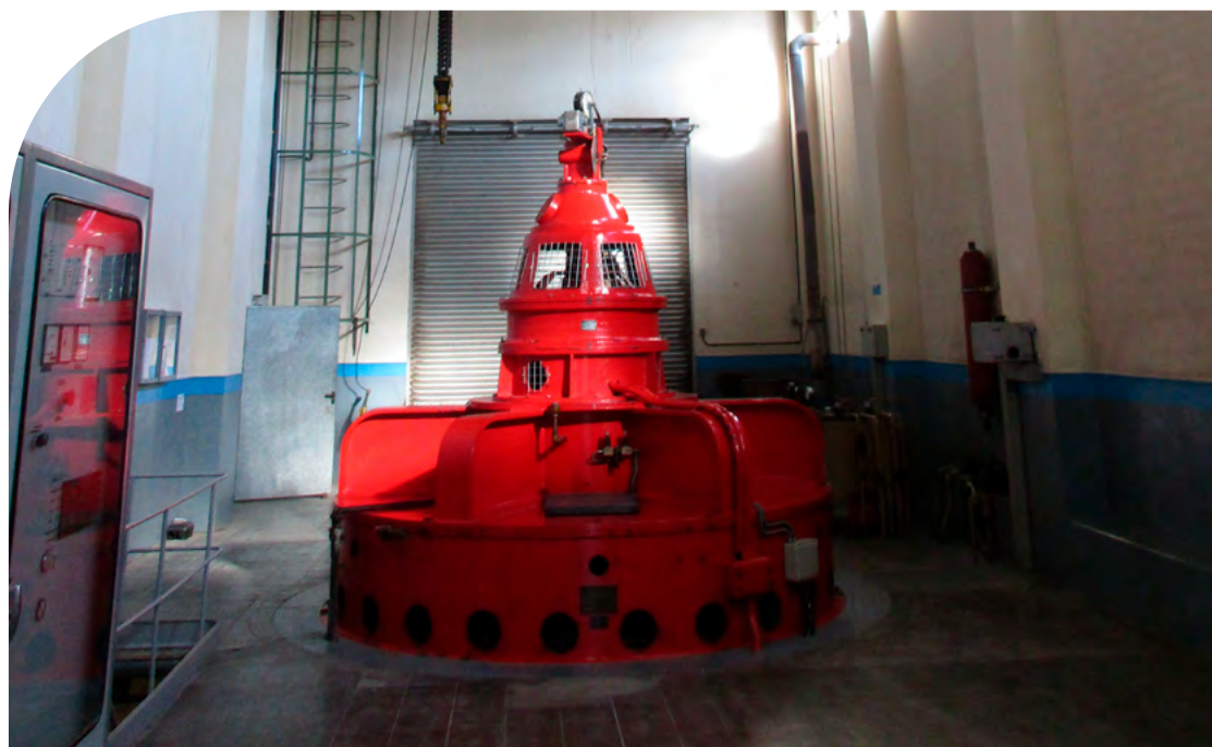
Interior de la Central Hidroeléctrica de Castillonroy (Huesca)
